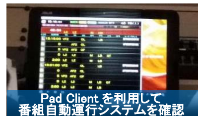
遠隔地からの監視の様子
